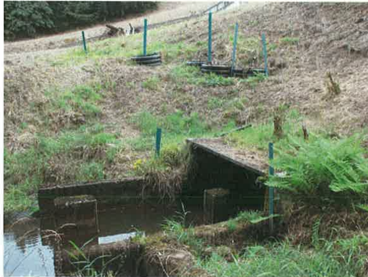
Low level conduit discharge and toe drains
